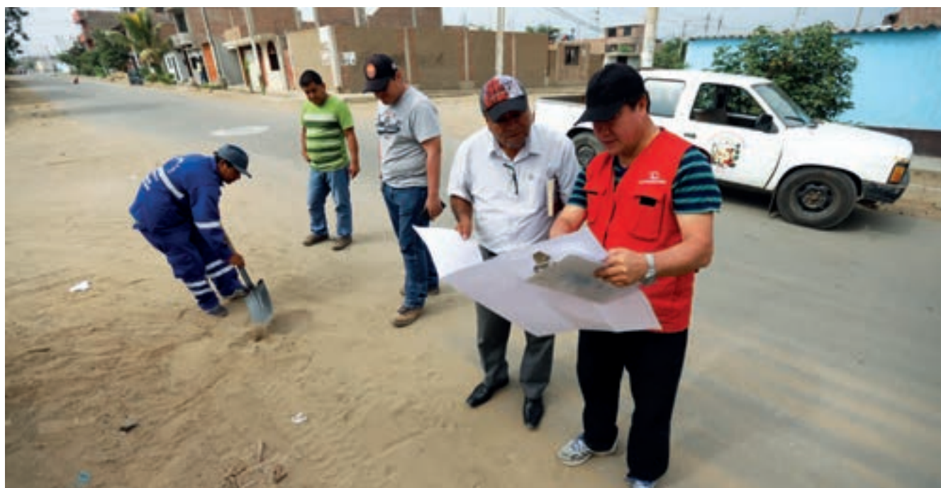
Audidores detectaron sobrevaloración del expediente técnico y pagos indebidos en la ejecución de la obra
