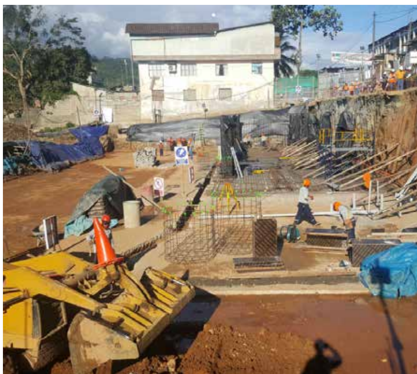
Demora en obras de Hospital San Francisco - VRAEM podría generar mayores pagos.
