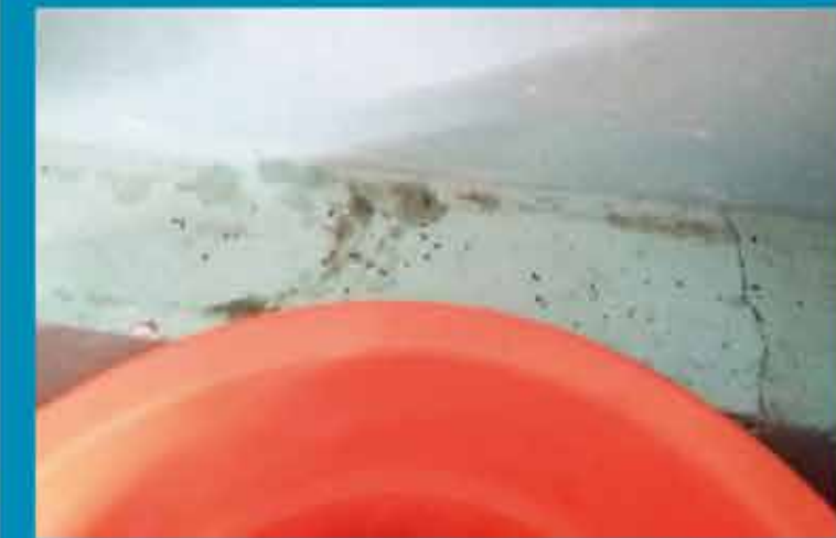
Presencia de orines y excremento de roedores. MP Castrovirreyna. Huancavelica.
